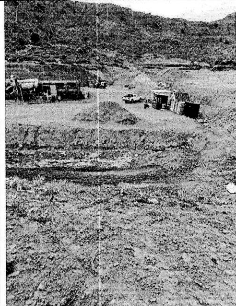
Foto 14: Canal de guarda junto al módulo de parcela 247
