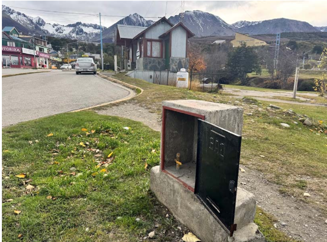
Imagen 4: Gabinete de gas
