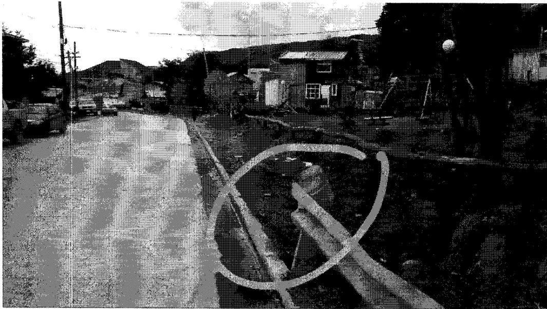
Detalle de extremo del guardarail chocado.
