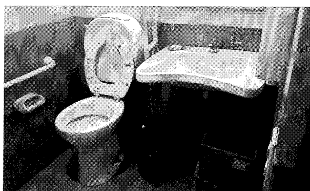
Toma Fotográfica N° 7: Se observa la falta de superficie de aproximación junto al inodoro especial.
