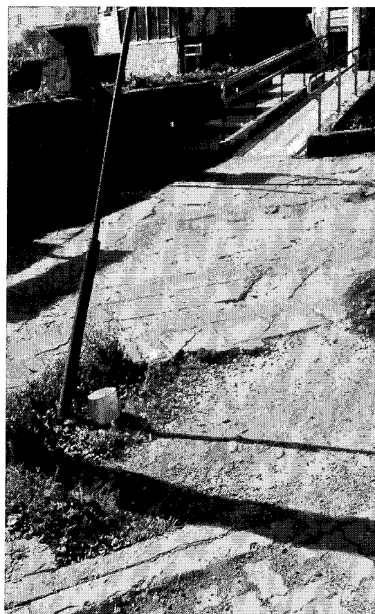
Toma Fotográfica N° 2: Se observan roturas de las veredas (a reparar en forma urgente), por representar un riesgo para cualquier tipo de peatón.
