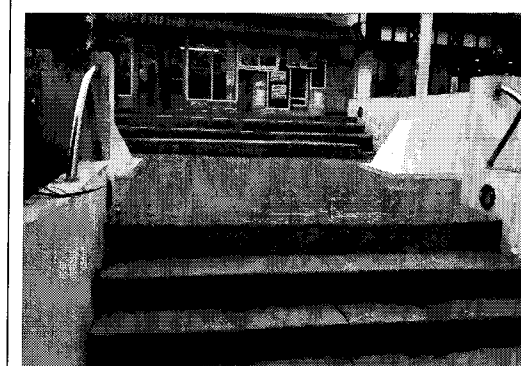
Toma Fotográfica N° 4: Se observa, falta de baranda c/ pasamanos, en escalera de entrada principal.
