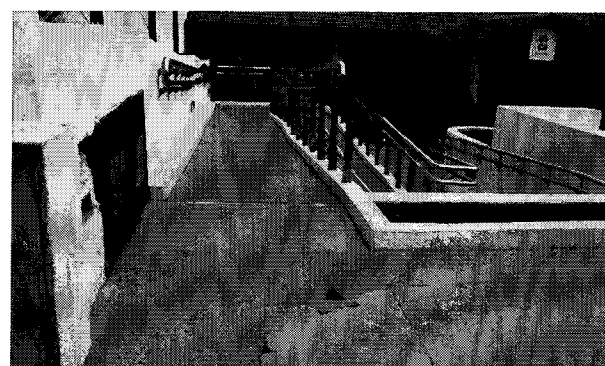
Toma Fotográfica N° 3: Se observa, falta de Baldosas de prevención indicando el acceso.
