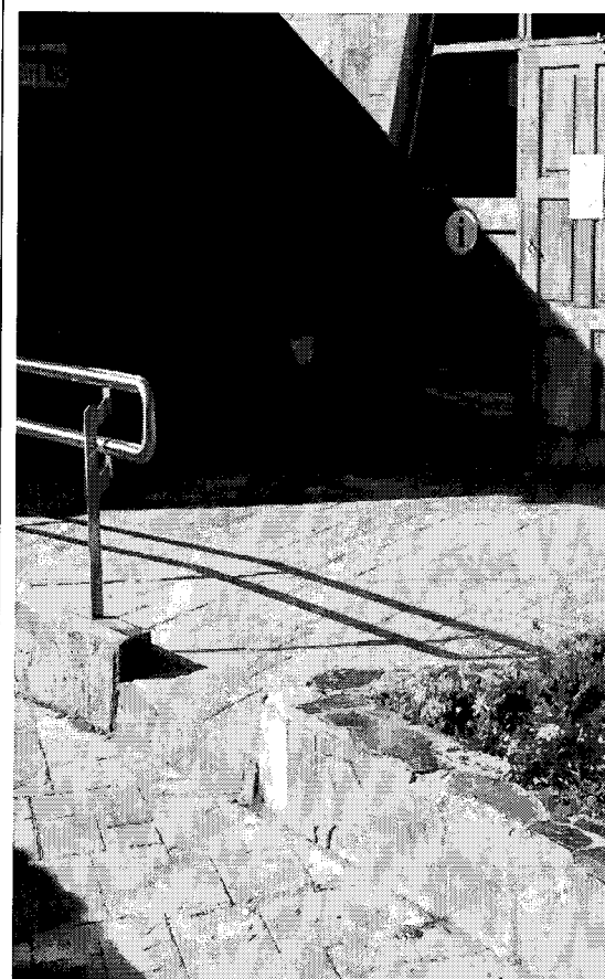
Toma Fotográfica N° 3: Se observa un (1) peldaño (escalón), lo que impide o dificulta el acceso de las personas con movilidad reducida.
