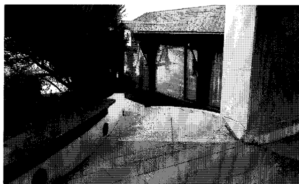
Toma Fotográfica N° 2: Se observa, falta de Baldosas de prevención indicando el acceso.
