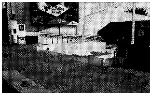
Toma Fotográfica N° 1: Se observa, falta de Baldosas de prevención indicando el acceso.
